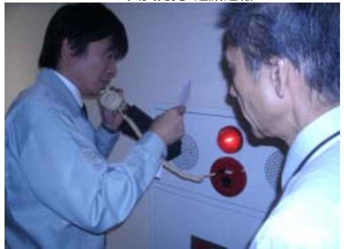
消火活動(屋内消火栓)
