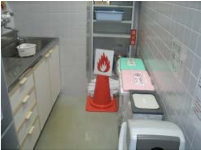
消火活動(消火器)
